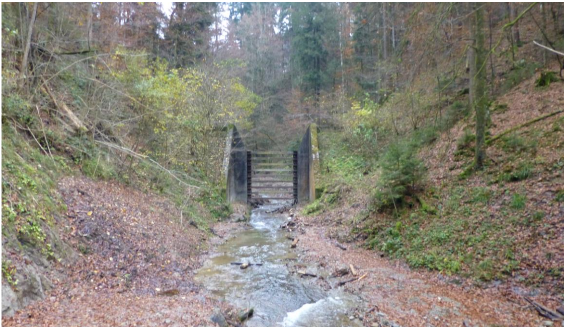
Abbildung 42: Geschiebesammler am Uelisbach: Mit der offenen Bauweise wird Geschiebe nur bei grossem Anfall zurückgehalten und später dosiert wieder weitergegeben. (12.11.2014)
