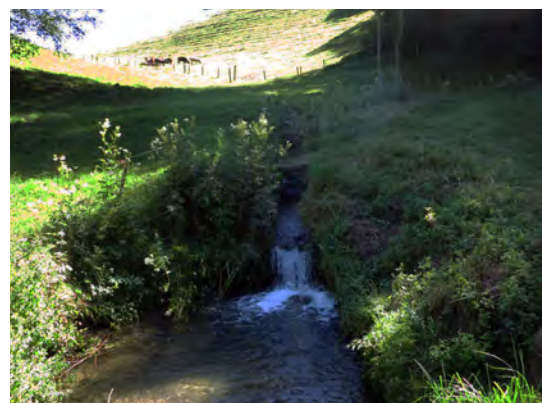
Abbildung 27: Relikte der alten Wasserfassung der Lochmühle Ufhusen (43204), die aktuell die Aufwärtswanderung der Fische unterbindet.
