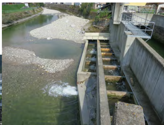
Abbildung 41: Wehrschwelle Kommetsrüti (links) mit rechtsufrigem Beckenpass (rechts).
