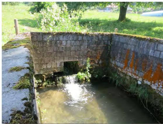
Abbildung 15: Wasserfassung des Kraftwerks Trisa (50001) im Dorfbach Triengen.
