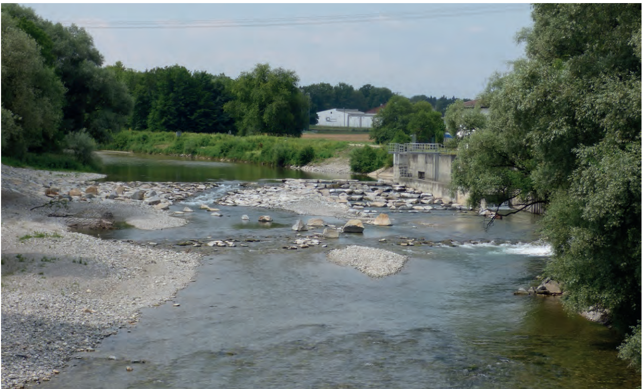
Übersicht Sohlgleite nach Umbau von unterstrom: linksseitig (orografisch) beckenförmige FAA, rechtsseitig Blocksteingleite mit Niedrigwasserrinne
