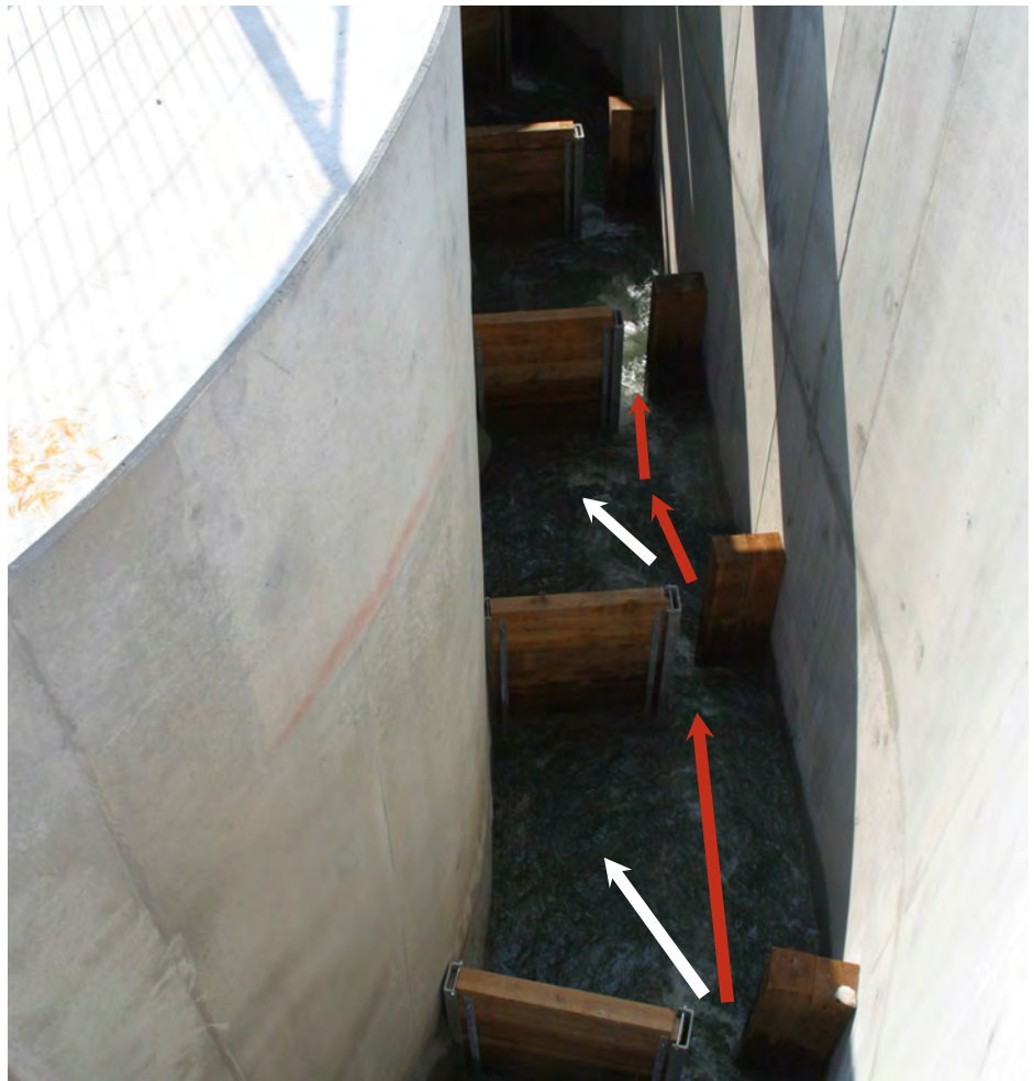
Abb. 18: Schlitzpass als eingeschränkt passierbarer Bereich: Hydraulischer Kurzschluss und Strömungsbeschleunigung durch falschen Strahlaustrittswinkel (rote Pfeile) im Schlitz (Wandkrümmung nicht ausreichend beachtet). Die weißen Pfeile zeigen die erwünschte „korrekte“ Strömungsrichtung an.
